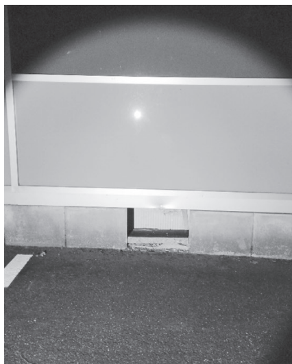
Beschädigte Fassade bei der Turnhalle Flamatt
